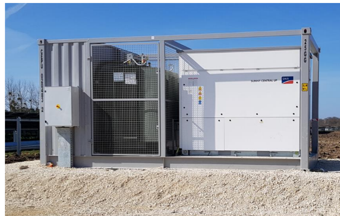
Photo 102 : Exemple de poste de transformation
