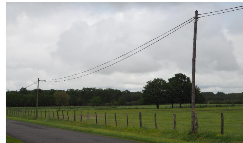
Photo 37 : Le réseau aérien Orange le long de la route qui accède au hameau les Barres (source : AEPE Gingko)
