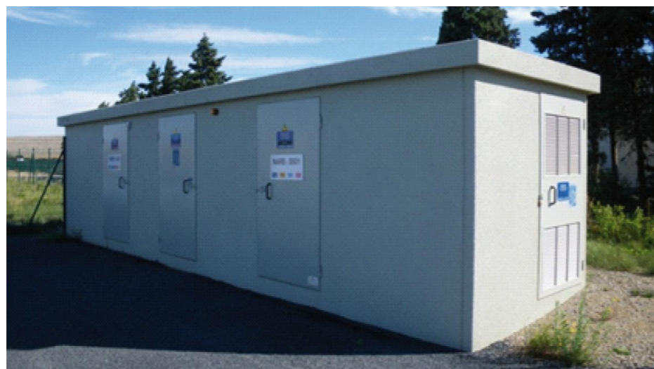
Photo 103 : Exemple de poste de livraison
